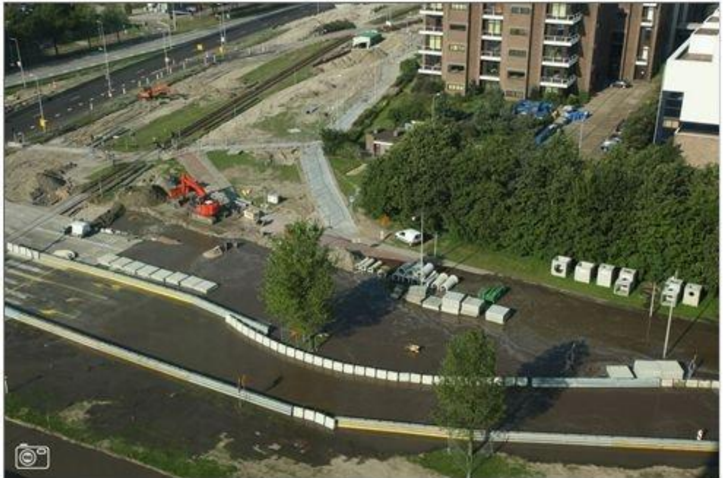
Waterleiding lek gestoten tijdens wegwerkzaamheden
